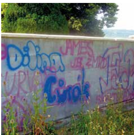
Hřbitovní zeď byla posprejována na ploše 48 m 2 .
