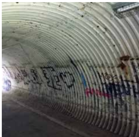
V podchodu pod dálnicí někomu „překážely“ elektrické kabely od osvětlení.
