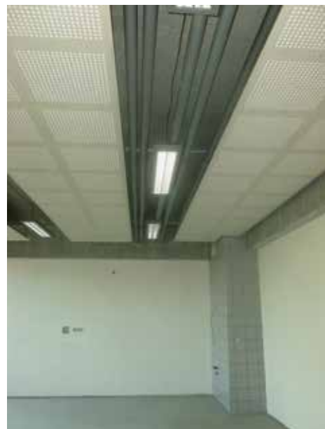
Školní učebna s přiznanými rozvody
